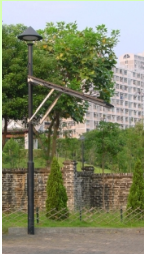
太陽能電燈 Solar lamp
