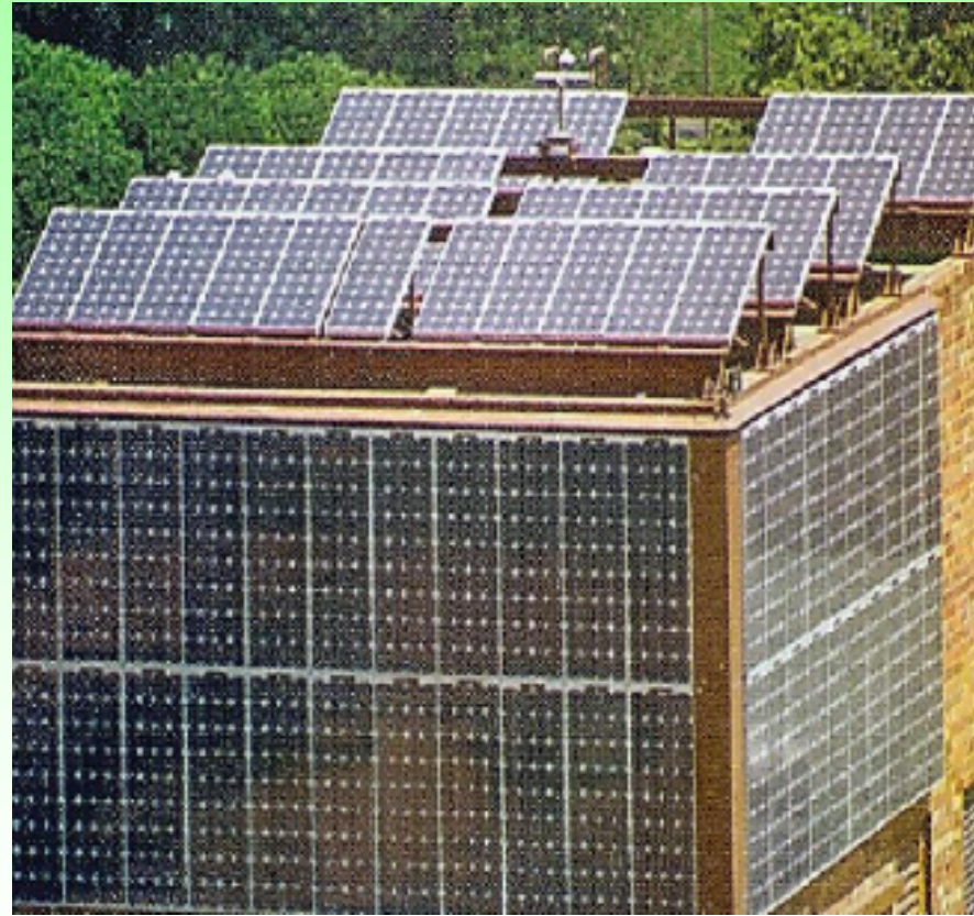
太陽能電板 Solar panel
