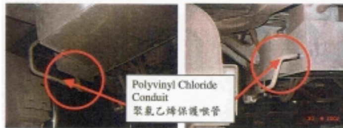
Photo 3 - Polyvinyl Chloride Conduit Arrangement (Before Modification) 相片三 - 聚氯乙烯保護喉管安裝(修改前)
