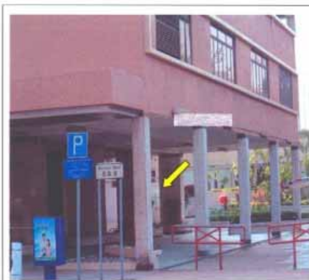
大廈出入口，有天花板但沒有圍封
