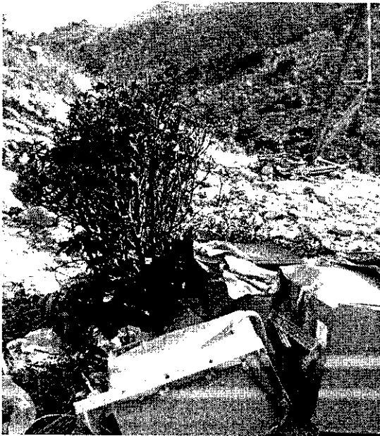
附圖一：承建商在中國吊鐘旁邊胡亂放置建築材料及垃圾，對中國吊鐘構成威脅。
