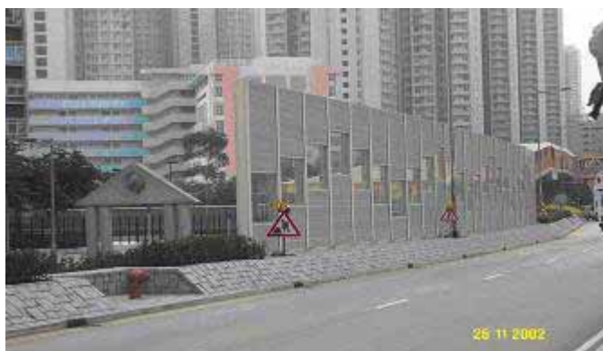
在天城路及天葵路之間沿天華路設置的隔音屏障。
