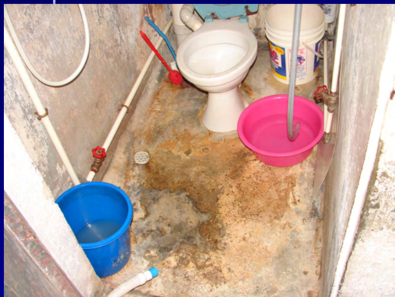
沒有地磚及防水 或漏水需要重鋪
