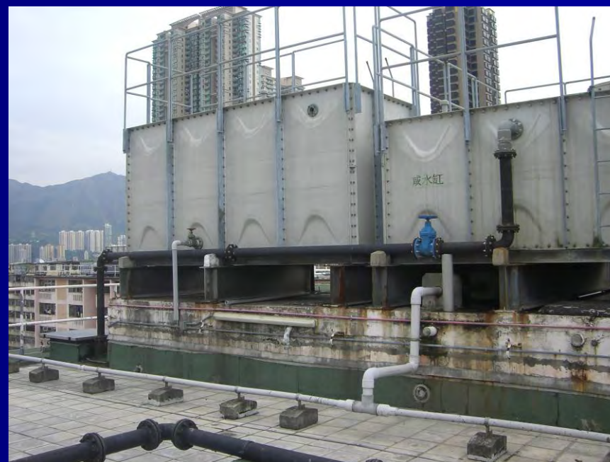
天台水缸 (食水、鹹水及消防缸)
