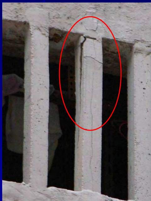
破損石屎欄杆
