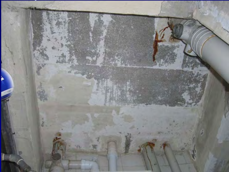
廁所石屎天花滲漏/剝落
