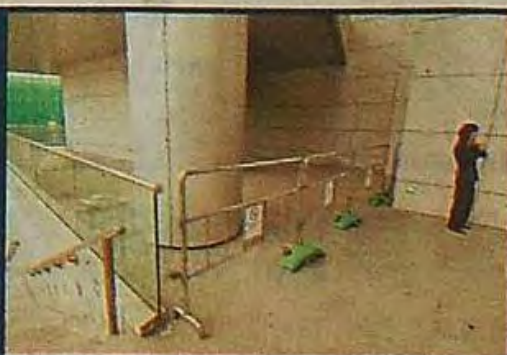
■東薈城通往3樓天台公共空間的樓梯，昨仍然被鐵欄封閉。
