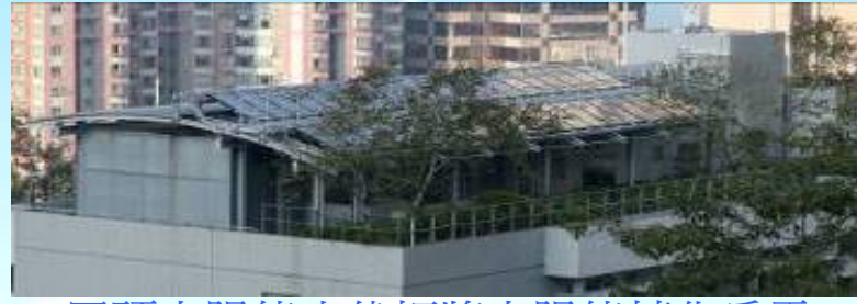
屋頂太陽能光伏板將太陽能轉化為電能，供樓宇使用
