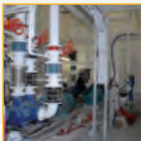
消防花灑和消防裝置泵房
