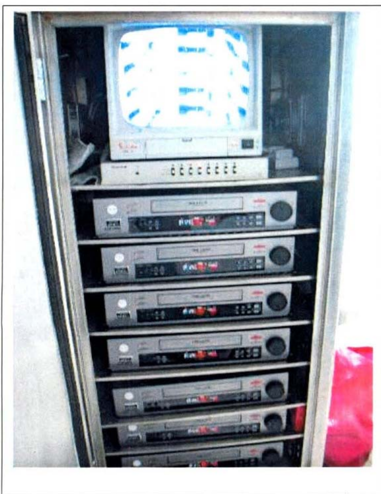
裝設在電錶房內的傳統監察系統儀器
