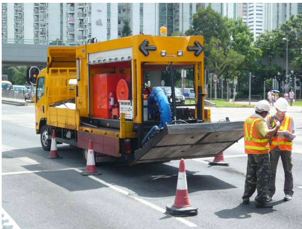
〔附圖三〕 道路維修人員正在安排 使用小型熱能修路機作小面積的路面修葺
