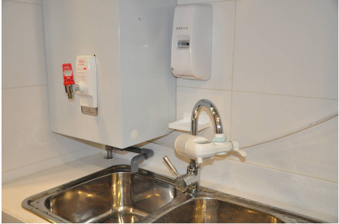
立法會綜合大樓內茶水房的水龍頭已加裝濾水器。
