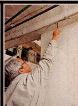
■橫樑上長長的裂痕，長遠會損害大廈結構。
