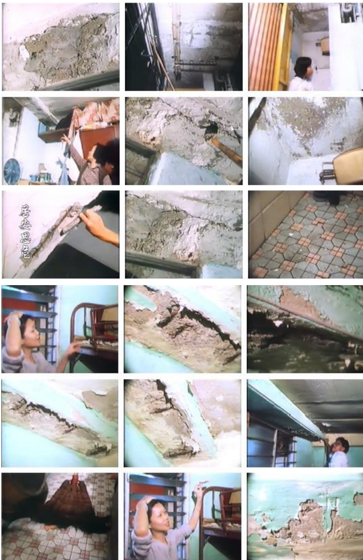
圖一: 729 座石屎剝落， 鋼筋生銹外露情況， (我們在這種環境， 最少生活了 15 年)
