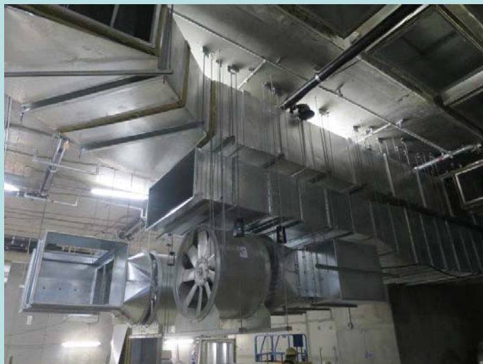
總站機電系統之大型設備與管綫
