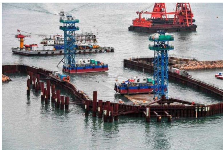
首件沉管隧道預製組件已成功安裝於維港海床(圖為沉放中的預製組件)
