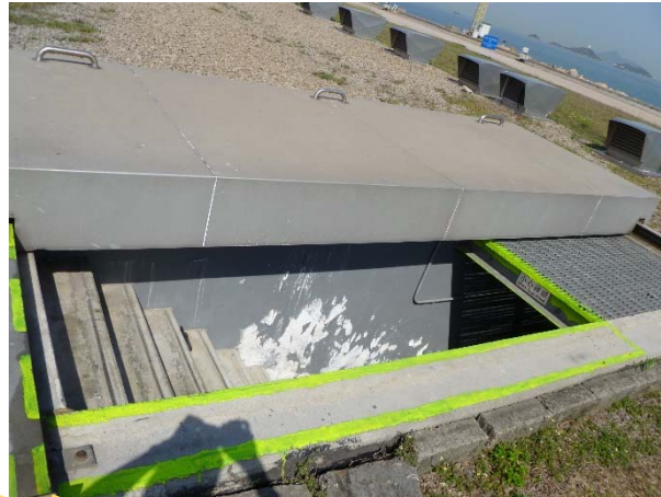
氣象監測設備 地下儀器室
