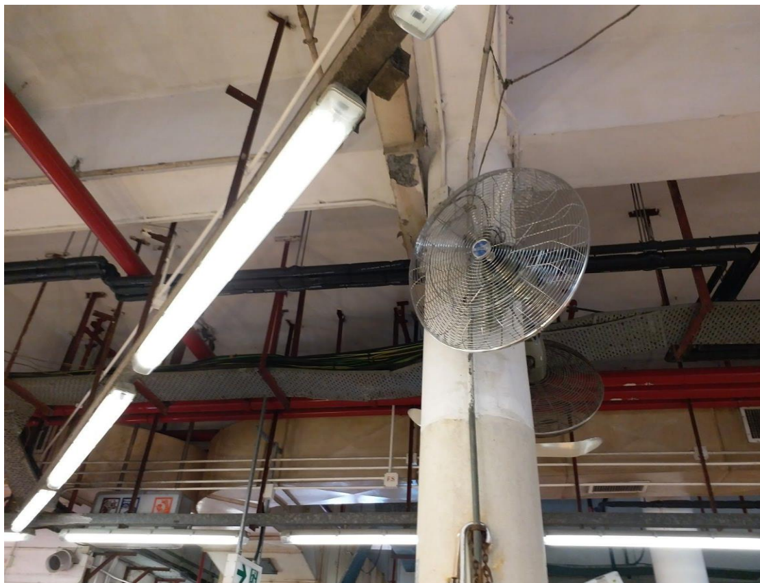
(風扇及通風管道殘舊)
