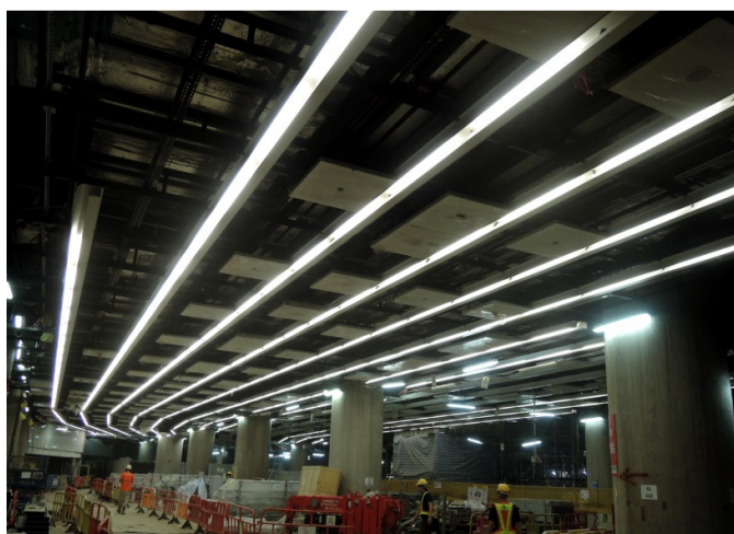
西九龍站內的抵港大堂已接通照明系統
