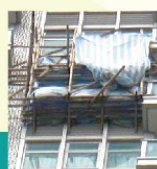
不良的吊棚安裝方法
