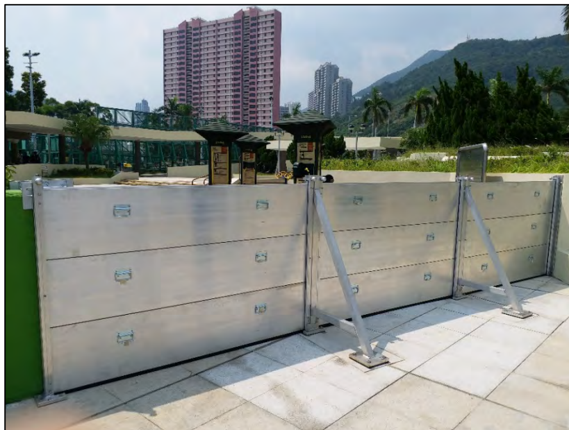
杏花邨遊樂場 可拆除式擋水閘
