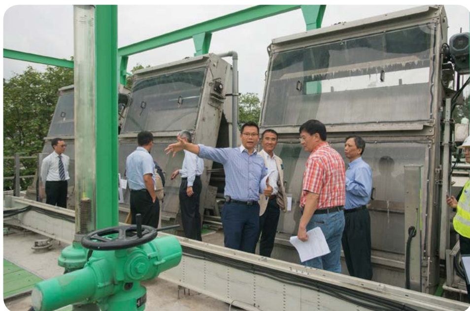
環境事務委員會委員視察屯門望后石污水處理廠的設施。
