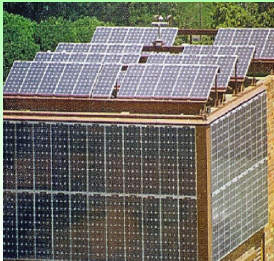
太陽能電板 Solar panel
