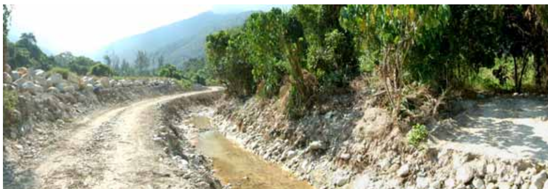
(a) 遭挖掘後(修復工程前)(2003年11月7日)
