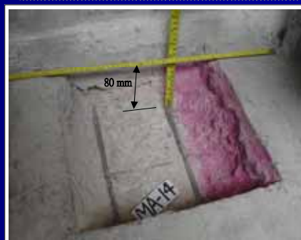
鋼筋偏離原來定位情況
