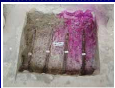
鋼筋銹蝕情況
