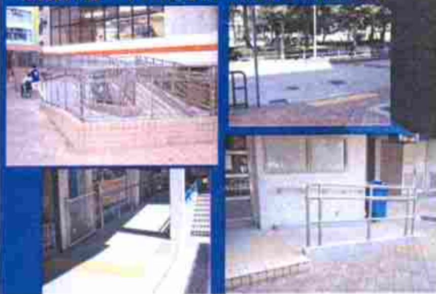
加設斜道，下斜路邊石，觸覺警告條和扶手
