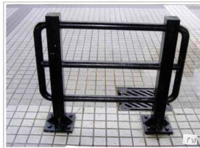
Photo P39 – Short Railing 相片 P39 – 船欄杆
