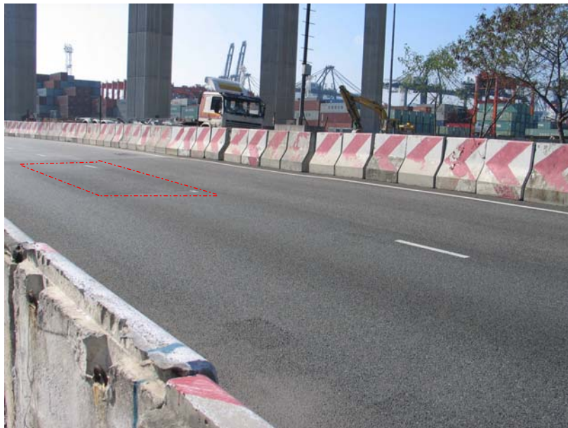
圖 6 - 在昂船洲高架道路合約下，防水系統試驗面板的狀況。紅色虛線顯示曾經變形但已修葺妥當的地方(出現變形的地方的瀝青面層厚度為 50 毫米，是試驗面板中最薄的面層)。
