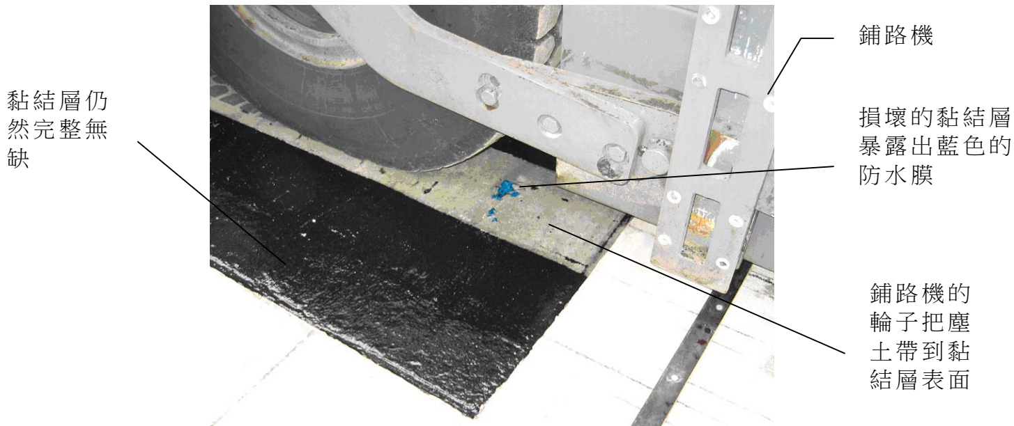
圖 3 - 在建造樣本以進行實驗室測試時所發現的黏結層損壞。從鋪路機輪子下面的地方可見，黏結層受到鋪路機輪子上的塵土污染。藍點顯示黏結層已經損壞並暴露出藍色的防水膜。
