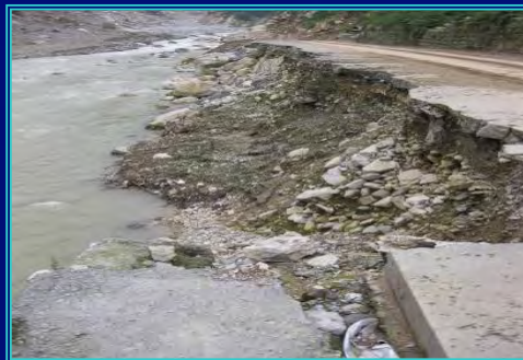
水流冲毀路基
