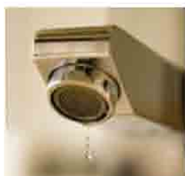
立即修理滴漏的水龍頭
