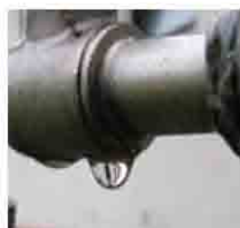
定期檢查家中水管有否滲漏
