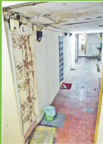
大角嘴洋松街工廈的非法出租的割房僅以木板間開，衛生成疑，部分電線鬆落，一旦發生火警，走火安全沒保障。地政總署兩度派員調查，業主均涉嫌以「鎖門不開」策略妨礙調查，反映地政總署針對違地契活動的巡查權力不足。（明報記者攝）
