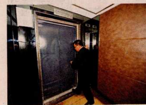
■測量師何鉅業乘專軌上 5 樓，並料粒門封閉，但內牆打開，縫隙易生意外。黃江奇攝
