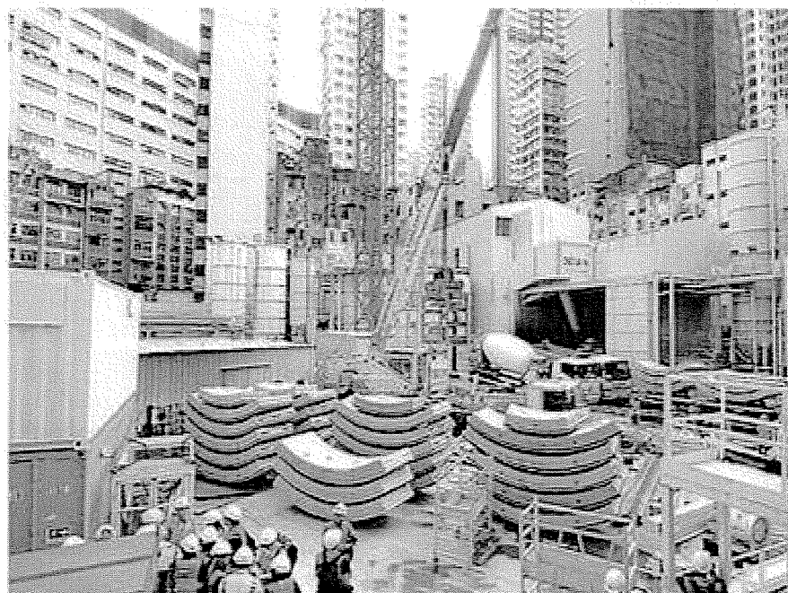
■截至今年1月底，當局收到202宗有關港鐵工程導致樓宇結構出現問題的投訴。
