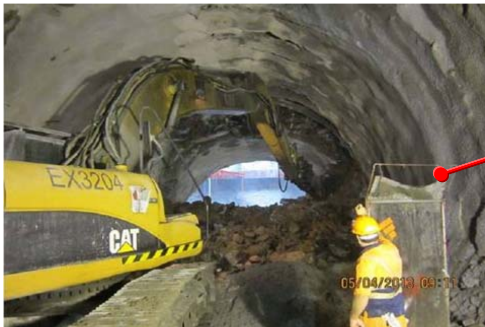
八鄉（北）之一段隧道已於2013年4月貫通 Tunnel breakthrough at Pat Heung (North) in April 2013
