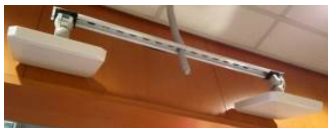
安裝在檢查站的RFID閱讀器
