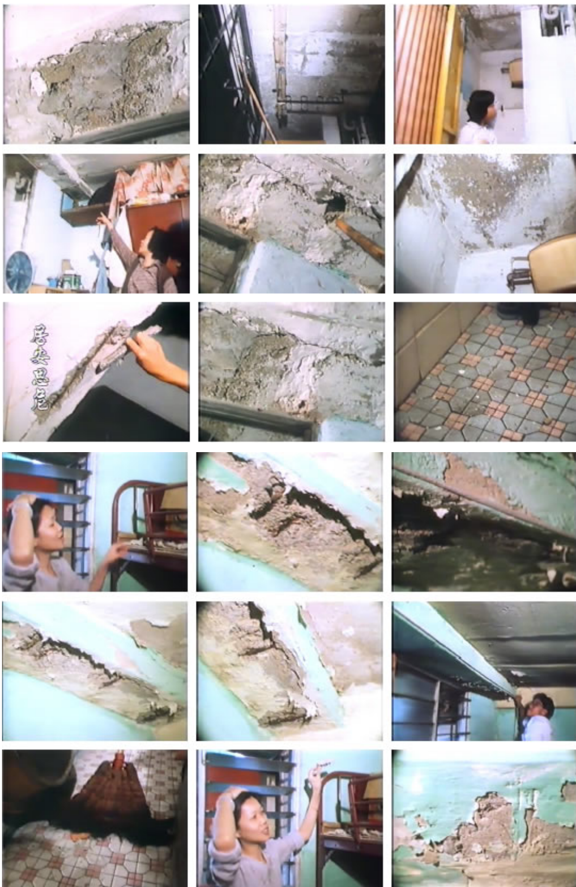
圖二: 729 座石屎剝落, 鋼筋生銹外露情況, (我們在這種環境, 最少生活了 15 年)
