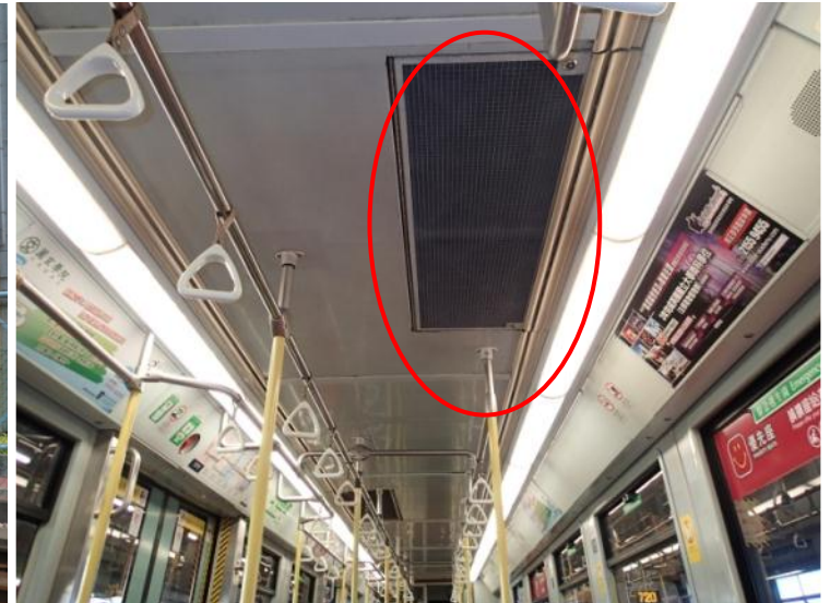
輕鐵車廂內的冷氣機風口
