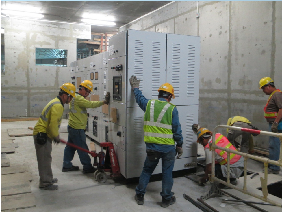
機電設備房 Equipment Room
