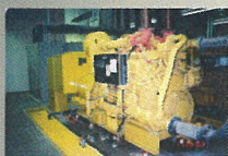
Emergency Generator 緊急發電機
