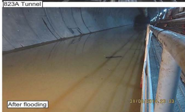
被水淹浸的隧道鑽挖機所在隧道
