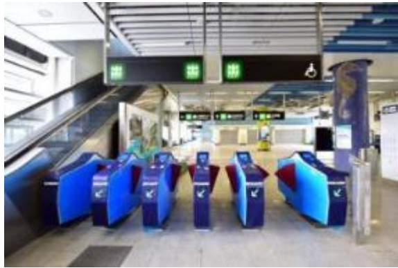
海洋公園站及黃竹坑站正進行車站設施及各項系統的測試
