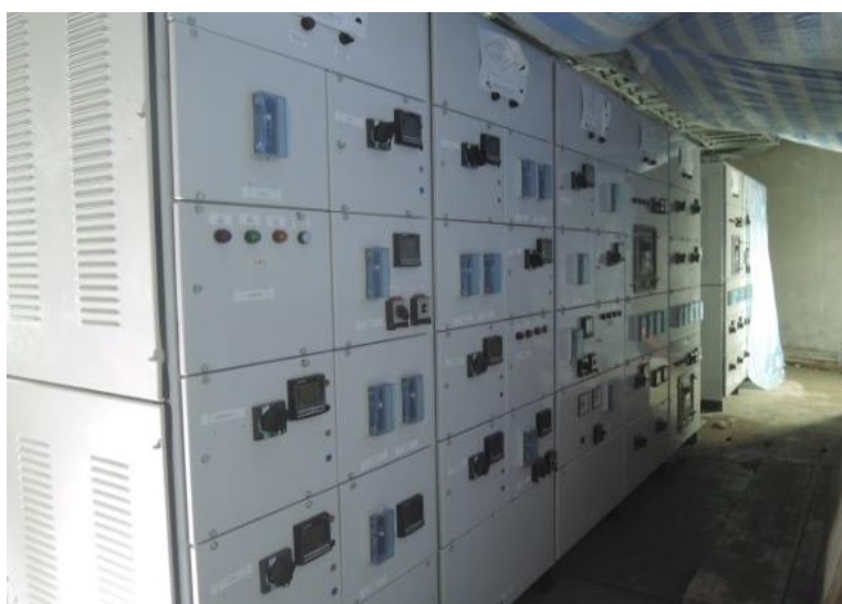
西九龍總站 B3 層的主要低壓電櫃開關裝置
