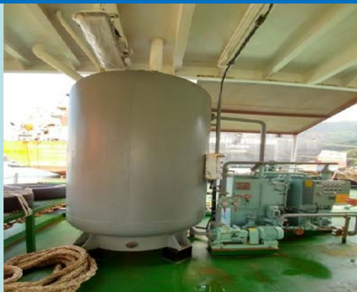
船上污水儲存缸接駁洗手間
