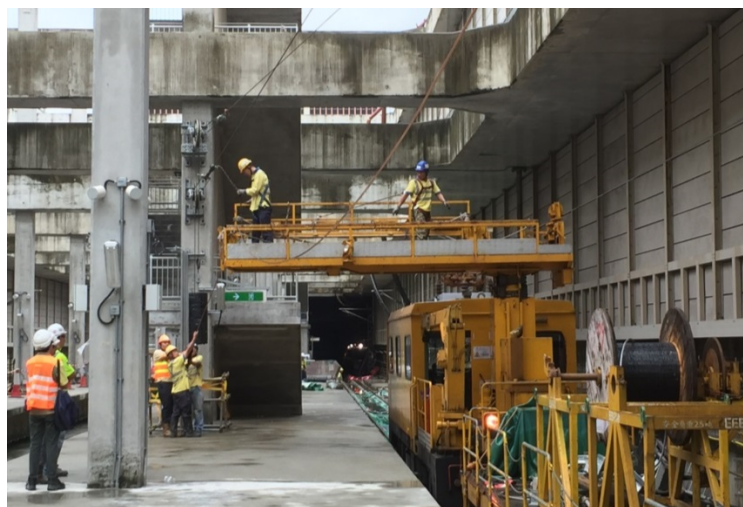
緊急救援處的架空電纜已準備就緒，供首列列車沿試行段隧道進行動態測試
