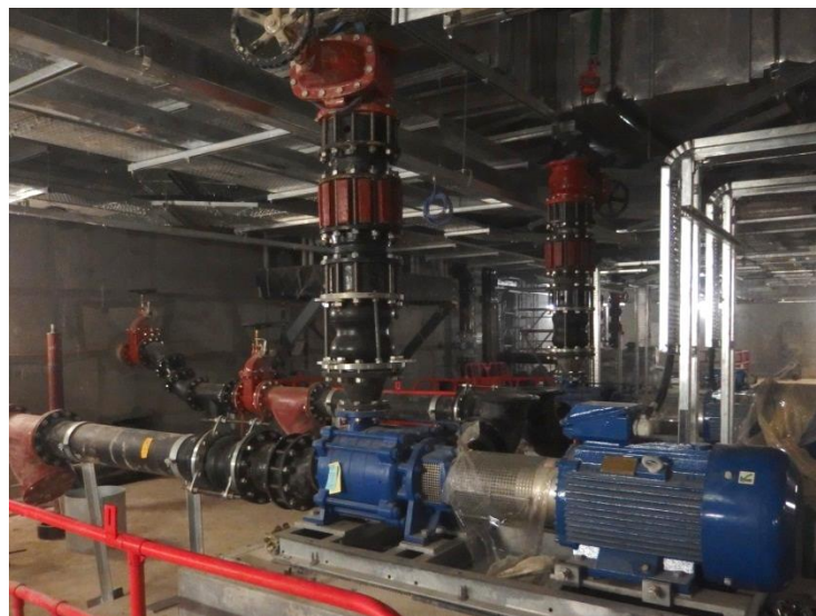
西九龍總站 B3 層泵房內的消防供水及排水系統
