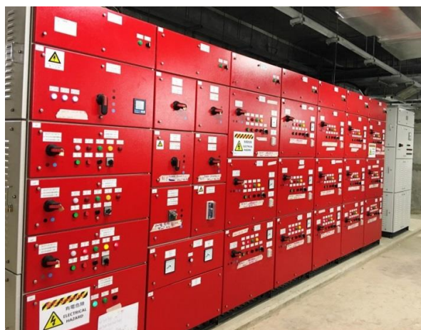
西九龍總站南面的電機控制中心已通電
