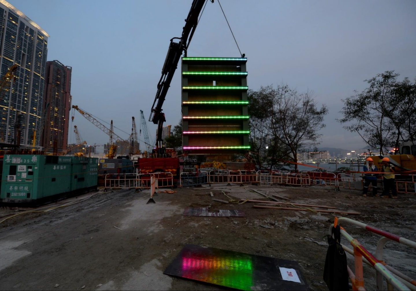
M+ Façade LED Demonstration M+ 建築物外牆的發光二極管示範操作
