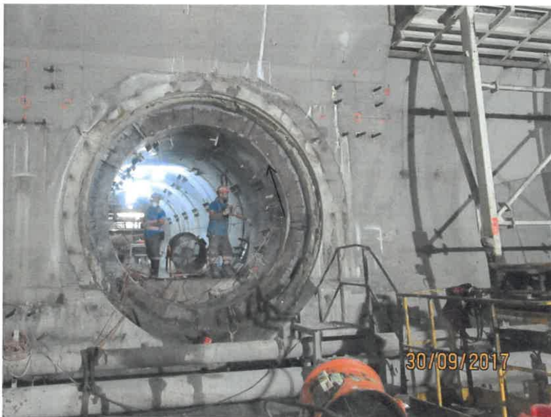
相片一— 臨時防漏措施（連接通道 17 號）（拍攝日期：2017 年 9 月 30 日）
