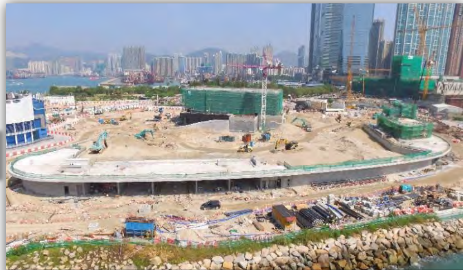
General view for RDE and Freespace 自由空間及零售／餐飲／消閒設施的工程概覽
