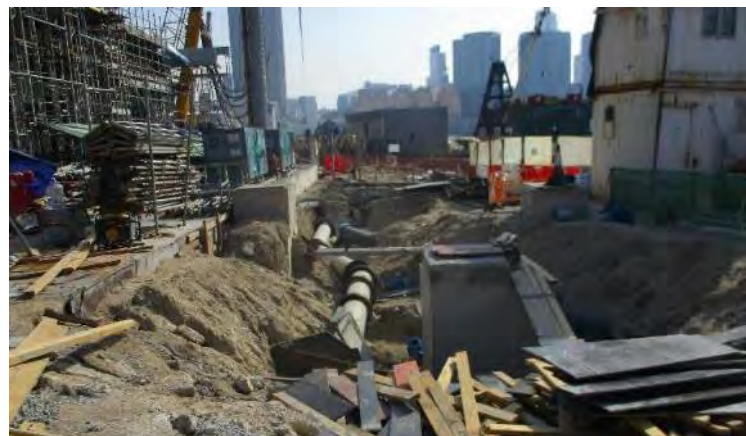
Portion D – KGO Water Mains D 部分 – 九龍政府合署製冷管
