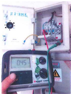
測試天台消防泵
