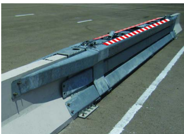
設置於中央分隔欄緊急通道的可移動防撞欄
